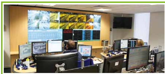
Fig. 3 : Exemple de salle de conduite moderne : supervision d'un tunnel ( http://tinyurl.com/kzogr9g ).
